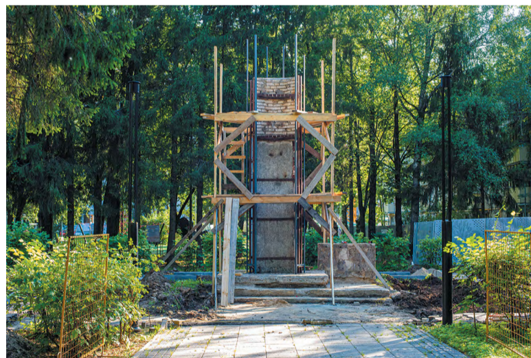
Стела Победы почти 50 лет ждала ремонта
