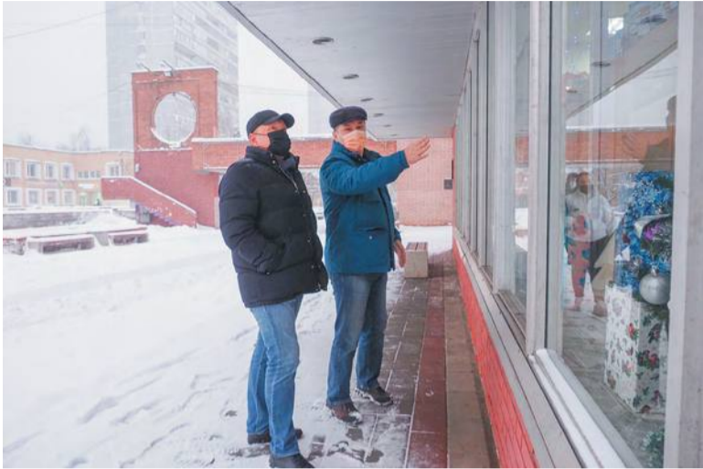
Участники рейда обнаружили немало изъянов на фасадах здания
